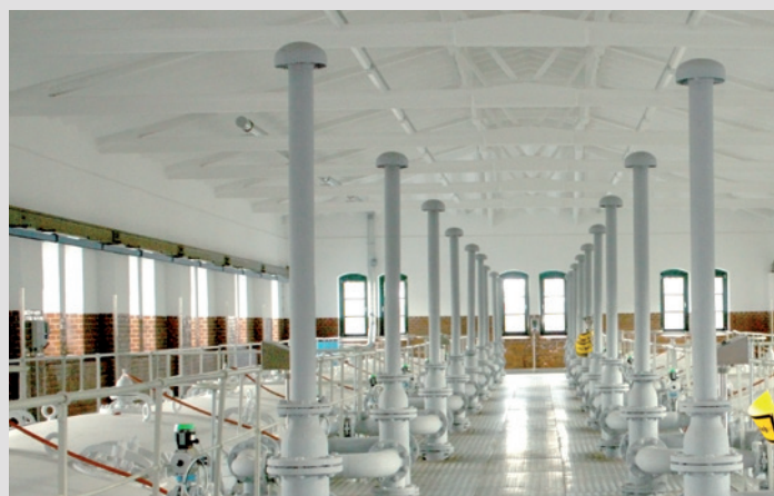
Bollman filtersysteem van een drinkwaterinstallatie met KefaTherm
